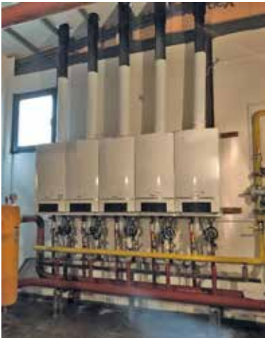
Şekil 2. Çatı katında bulunan kazan ve dik hermetik çıkan baca örneği
